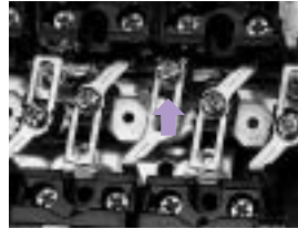
切替金具を200V側にスライドする。切替金具の接続ねじを締め付けて200Vへの切替え完了です。
